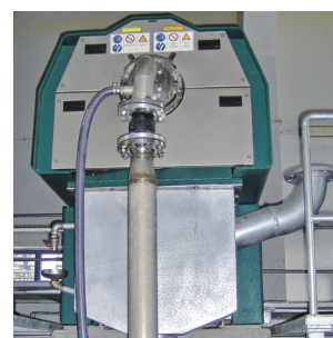
Stația de epurare: centrifugă pentru deshidratarea nămolului
